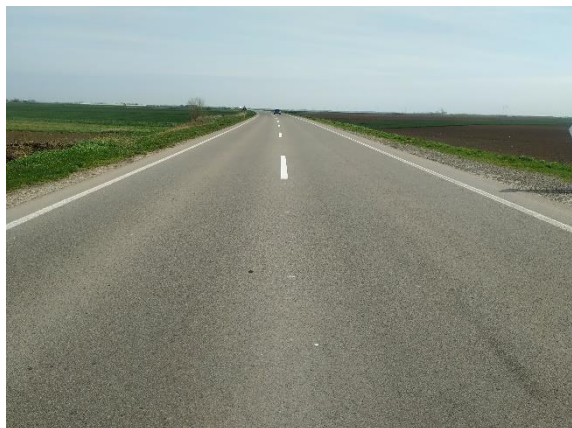
Слика 2. Стање површине асфалтног застора - 2023. год
