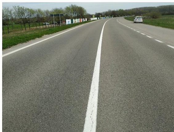
Слика 6. Стање површине асфалтног застора - 2023. год
