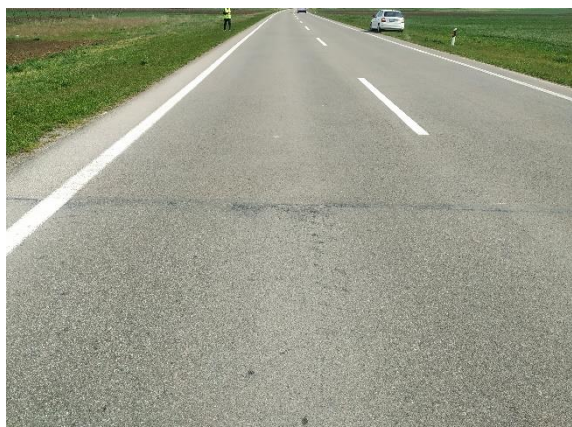
Слика 3. Стање површине асфалтног застора - 2023. год
