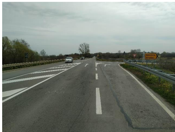
Слика 7. Стање површине асфалтног застора - 2023. год
