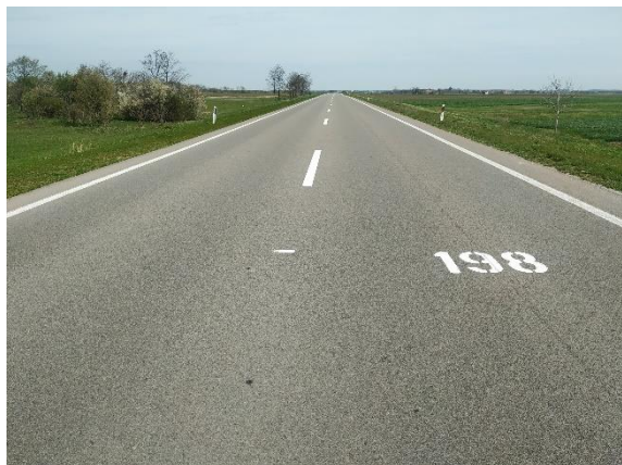
Слика 4. Стање површине асфалтног застора - 2023. год
