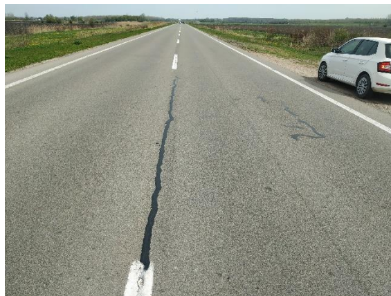
Слика 5. Стање површине асфалтног застора - 2023. год
