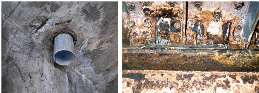
Slika 2. Pre rekonstrukcije: ispuštanje vode sa kolovoza kroz otvore kratkim cevima (levo) i korozija na čeličnoj konstrukciji centralnog raspona (desno) posle gotovo 6 decenija korišćenja mosta Gazela.
