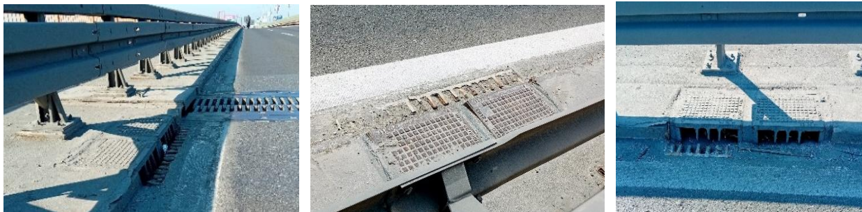
Slika 9. Zapušeni i deformisani slivnici i dilatacija na najvišem centralnom delu mosta Gazela koji se najviše ugiba i gde su uslovi za slivanje vode promenljivi i praktično „neregularni”.
