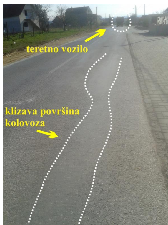
Slika 3. Osmatranje klizavih površina kolovoza od asfalt-betona sa habajućim slojem od krečnjaka na putnom pravcu II reda Topola – Bućin grob pre rehabilitacije (Izvor: Institut za puteve, Odeljenje za kolovozne konstrukcije, mart 2016).
