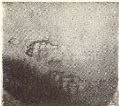
Сл. 3. Оштећења од мрза
