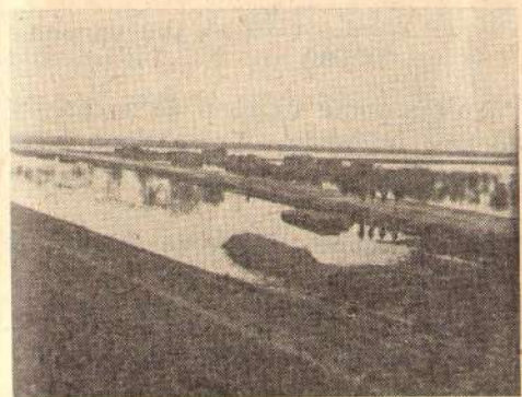
Sl. 7. Raskvašen nasip na km. 11 + 100.
