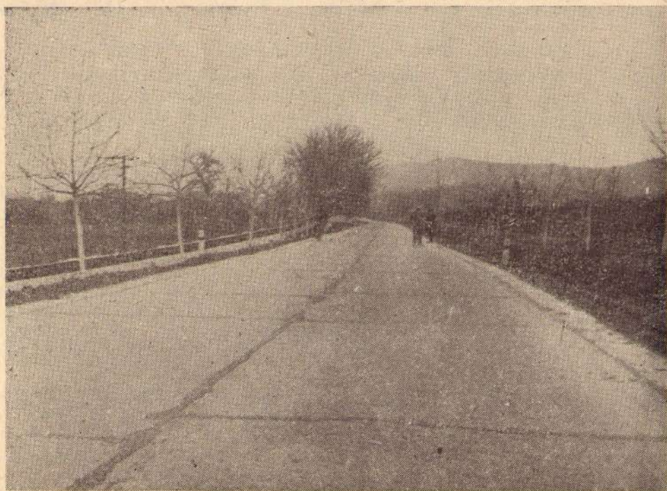
Sl. 27. Izgled betonskog kolovoznog zastora sa poprečnim pukotinama ispred Bele Palanke
