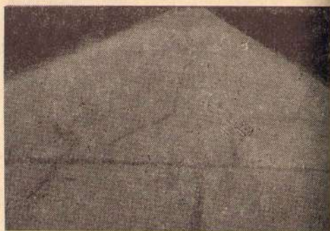
Sl. 3. Pukotina na betonskom kolovozu na podlozi uvaljanog tucaničnog zastora, izrađenom 1934. godine na putu Senec—Nitra—Bratislava—Komarno, km 33—37 u Čehoslovačkoj
