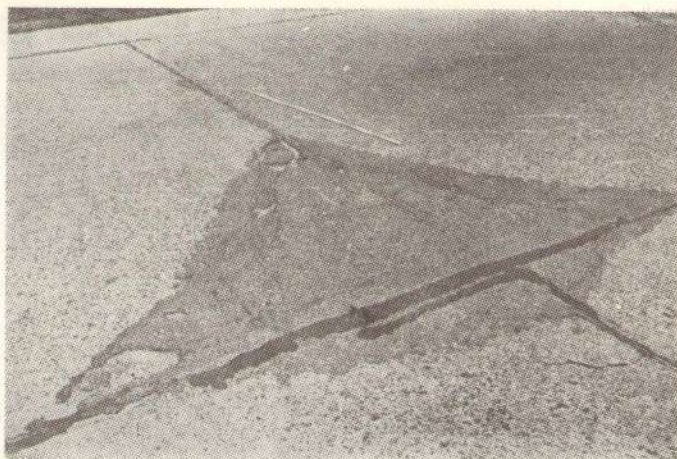
Слика 7. Пуцања на угловима бетонских плоча — тип 2.2.
