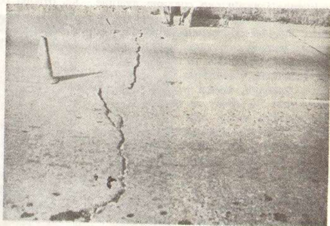
Слика 4. Попречне пукотине око средине дужине обе плоче, по целој ширини коловоза — тип 1.4.
