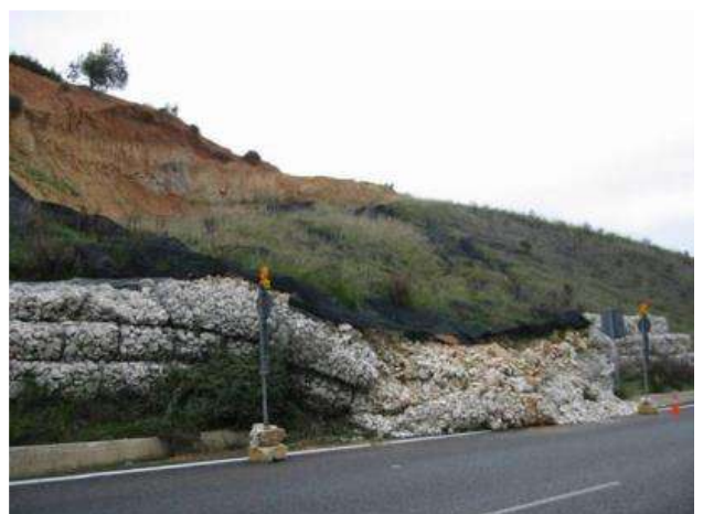
Slika 7. Loša zaštita gabionskim zidom
