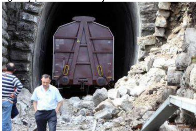
Slika 1. Odron kamenog zida ispred tunela Kupjak u Hrvatskoj
