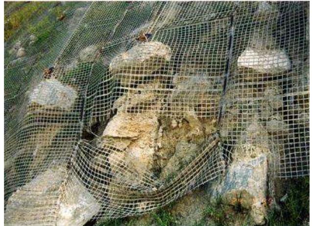
Slika 6. Slaba zaštita geogridom
