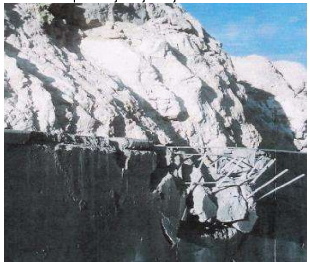
Slika 8. Oštećenje nefleksibilne konstrukcije betonskog zida
