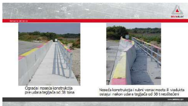
Slika 2. Ograda i noseća konstrukcija pre i posle udara tegljača od 38 tona
