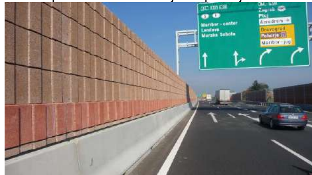
Slika 6. Ograda za zaštitu od buke na srednjoj traci autoputa A1 – Maribor Slovenija DB 100 LSW-M / H4b W5 sa, visina zida za zaštitu od buke 400cm,
