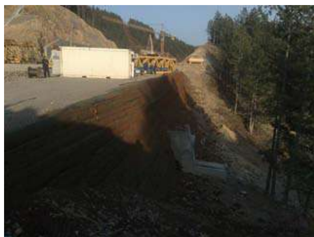
Slika 16: Cevasti propust na malom armiranom nasipu
