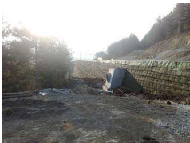
Slika 15: Cevasti propust na velikom armiranom nasipu
