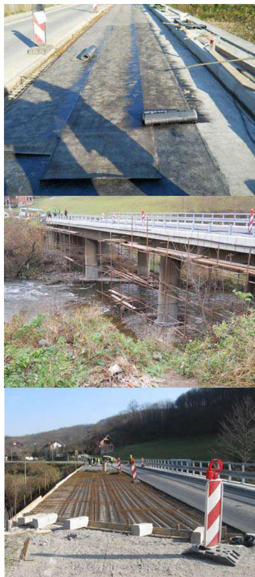
Слика 2. Санација моста
