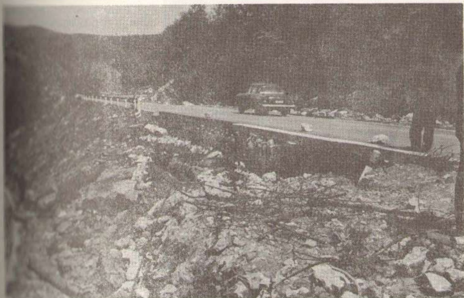
Сл. 3 — Оштећење пута бр. 15/1 код Бистрице
