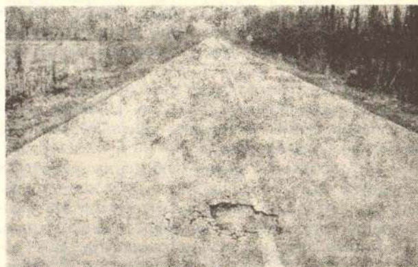
Сл. 8 — Пут Тетово — Гостивар. Није тешко дефинисати опште стање тог пута са изразитијим ударним рупама, надвишеним банкама, колотразима и улегнућима местимичан лом коловозне конструкције итд.
