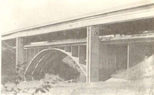
Сл. 1 — Мост дужине 229 m преко реке Желшне на ауто-путу Праг—Брно—Братислава и радни излаз дужиног моста на обилазници
