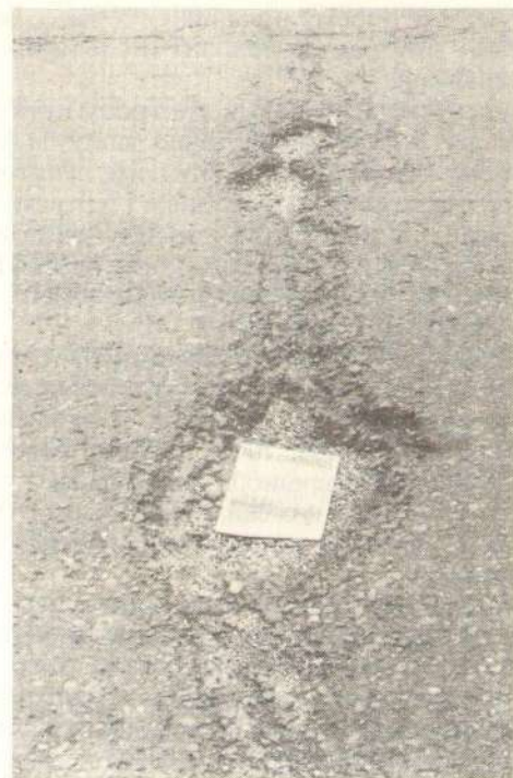
Сл. 6. Прслине и ударне рупе ујравне на осу ауто
