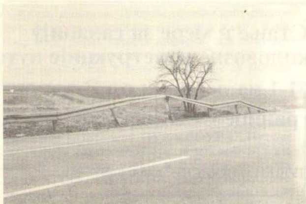
Сл. 2. Оштећена заштитна ограда
