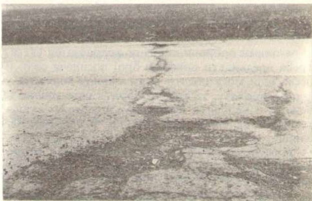
Сл. 5. Прслине и ударне рупе ујравне на осу ауто
