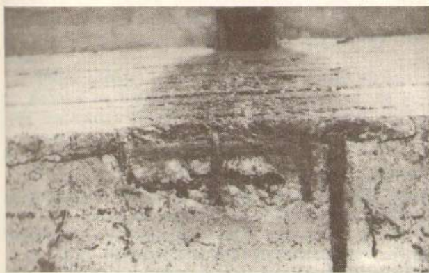
Сл. 4 — Оштећење бетона и челичне арматуре главне носача због лоше урађене сливника
