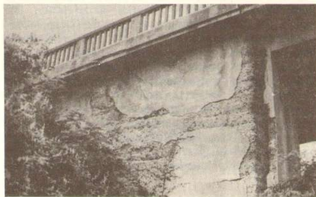
Сл. 1 — Оштећења бетона обалног стуба и првог стуба континуалне греде због оштећене дилатације, лошег положаја сливника
