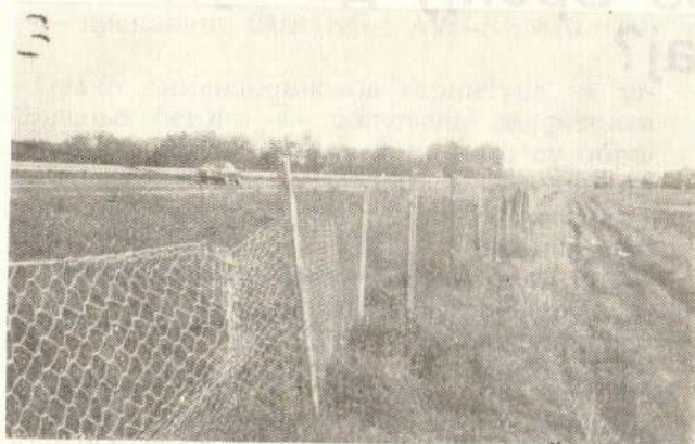
Сл. 2 — Неовлашћено отворен пролаз кроз заштитну ограду аутопута
