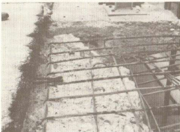
Сл. 1. Оштећена пешачка стаза на плочастом пропусту
