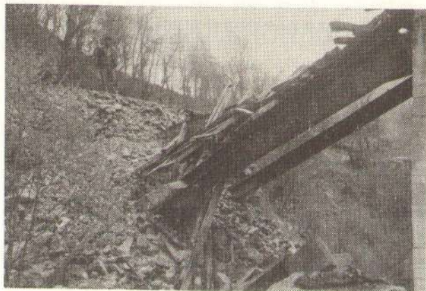
Слика 2 – Изглед оштећеног моста на регионалном путу у општини Ариље
