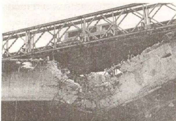
Слика 18. Оштећење крајњег подужног носача и део решеткиасте конструкције за санацију после првог ракетирања
