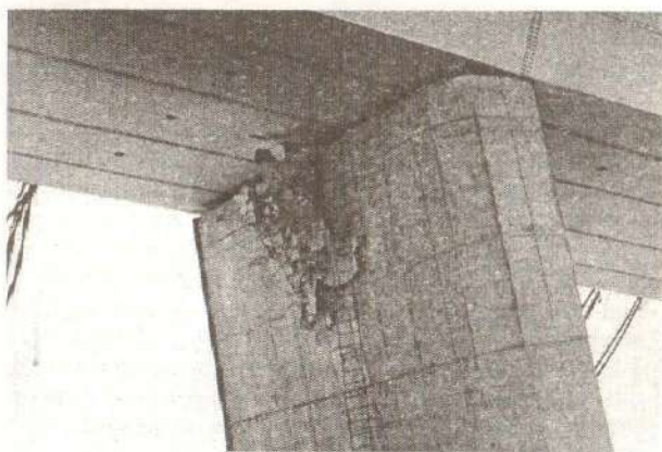
Слика 9. Детаљ оштећења врха стуба
