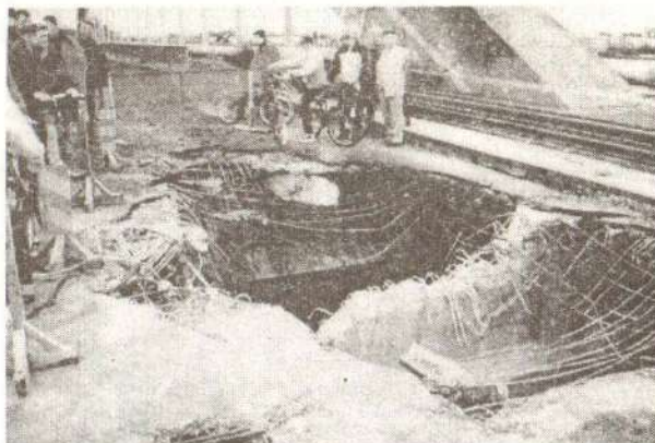
Слика 16. Оштећење коловозне конструкције после првог ракетирања
