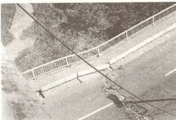
Слика 11. Рушење и прелом последњег поља прилазне конструкције са десне стране
