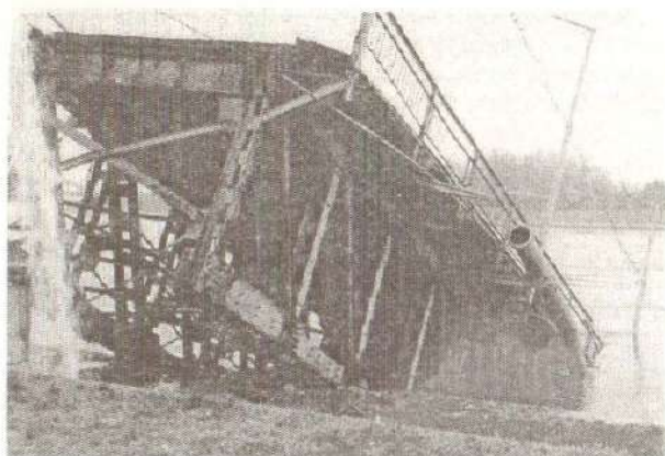
Слика 26. Рушевине армиране конструкције Варадинског моста на новосадској страни
