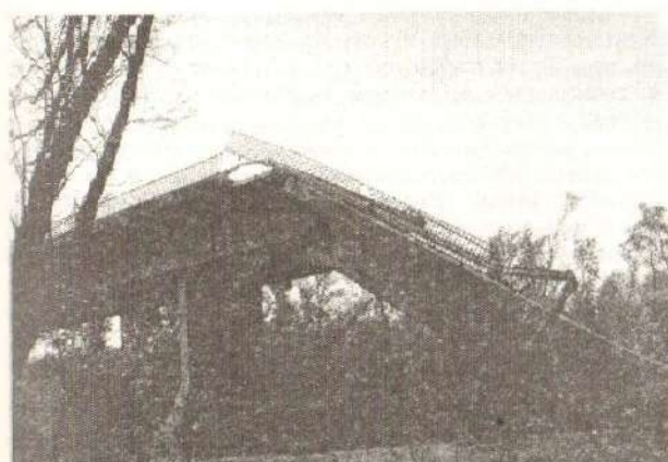
Слика 30. Срушено поље прилазне мостовске конструкције
