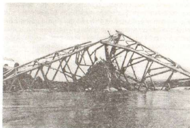
Слика 25. Изглед поломљене челичне конструкције са низводне стране
