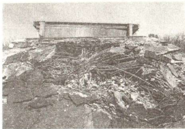
Слика 32. Детаљ срушене и оштећене коловозне конструкције
