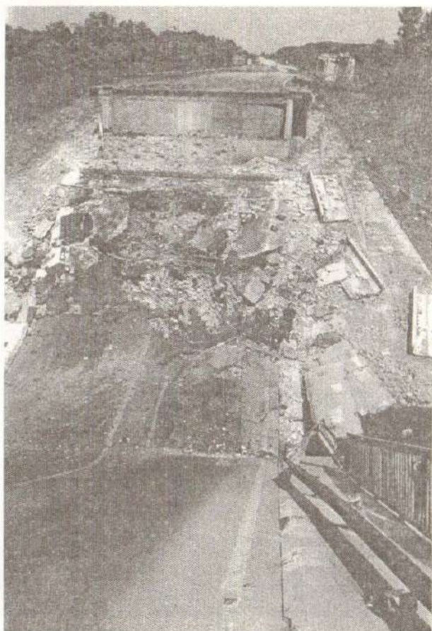
Слика 33. Изглед срушеног поља прилазне конструкције из правца Београда
