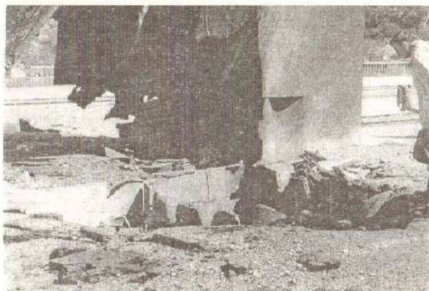
Слика 13. Детаљ оштећења базе пилона са десне стране моста
