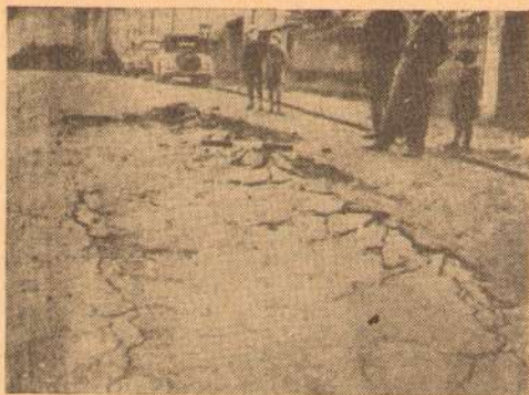
Сл. 18 — Оштећење асфалтног коловоза услед мрза због слабе подлоге на једном немачком савезном путу
