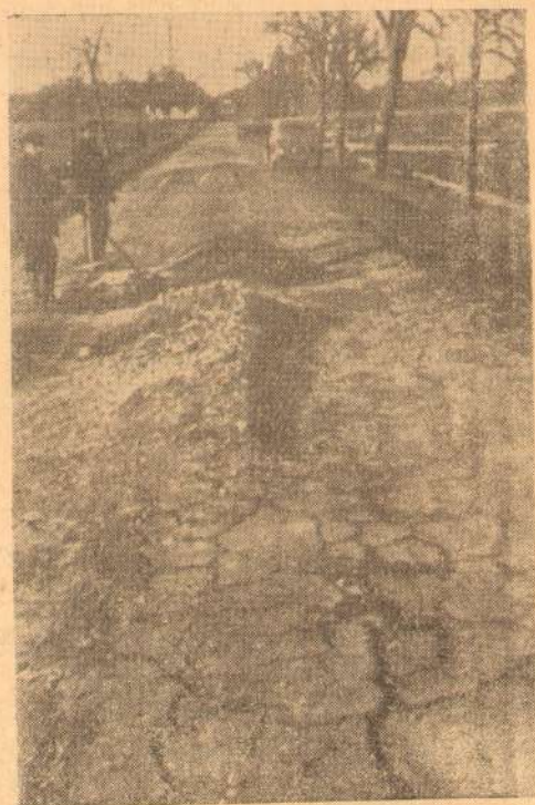
Сл. 17 — Оштећење асфалтног коловоза услед мрза због слабе подлоге на једном немачком савезном путу
