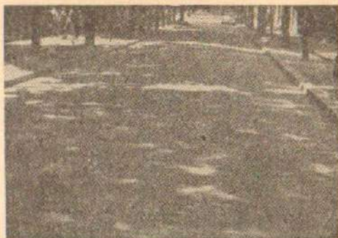
Сл. 3. Застор од цементног бетона израђен пре 30 година са доста пукотина
