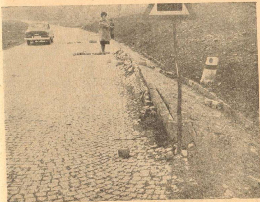
Сл. 4 Детаљ деформисаног пута на 106. км
