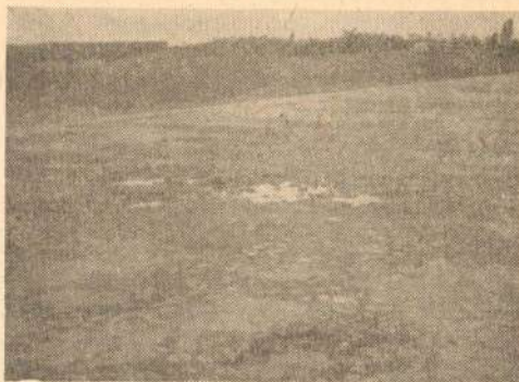
Сл. 18. Оштећења на коловозном застору од цементног макадама
