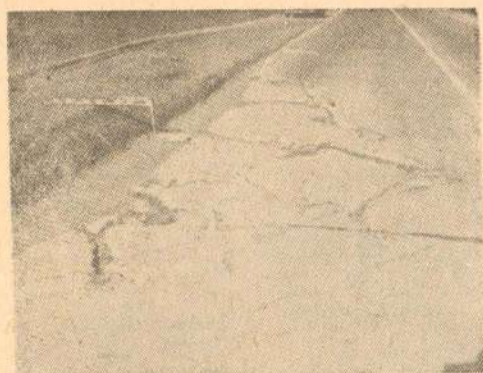
Сл. 8. Разарање цемент-бетонског коловоза
