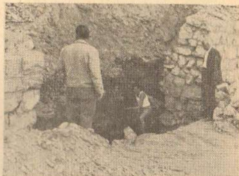
Сл. 4. — Срушен потпорни зид — фундиран на песковитим глинама речне долине у подножју падине
