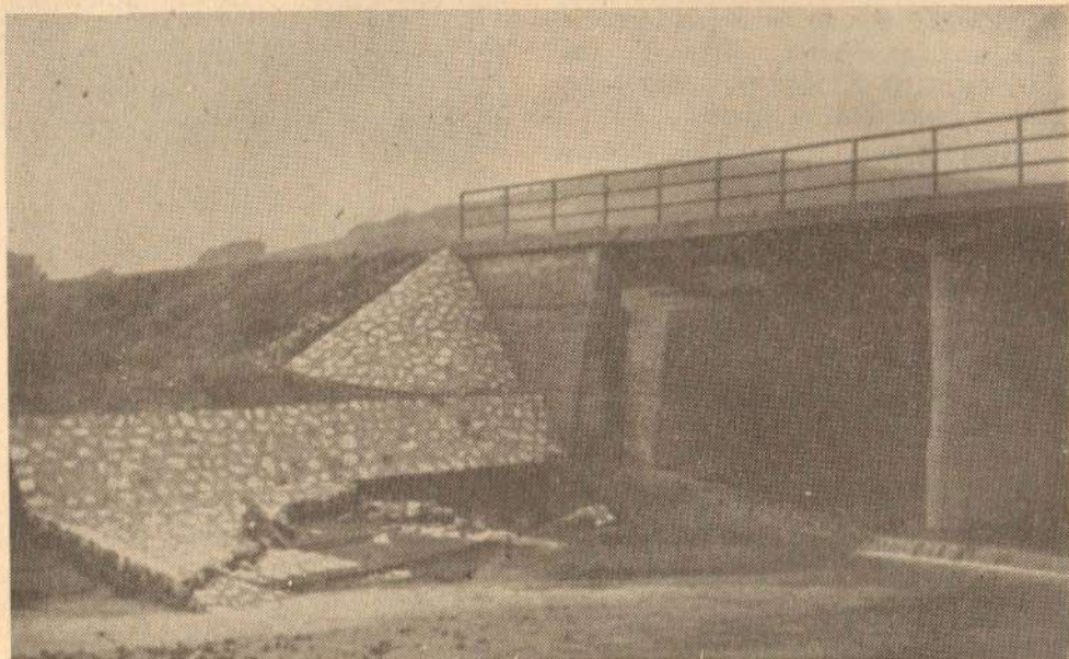
Сл. 5. Рушење стуба и обложеног зида моста у кориту реке (фото инж. Љ. Палавестрић).
